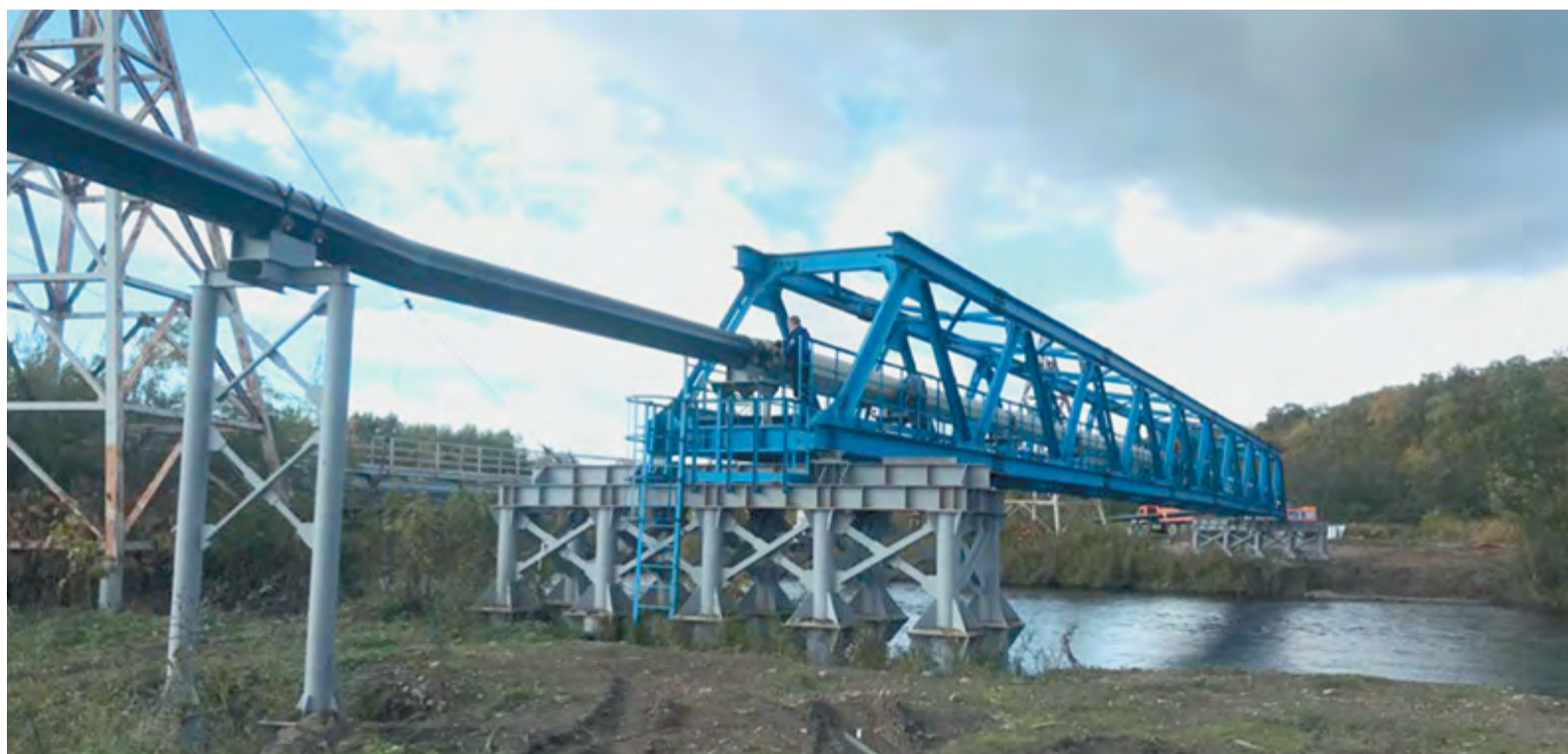
На Камчатке все переходы магистрального газопровода через реки – в надводном исполнении
